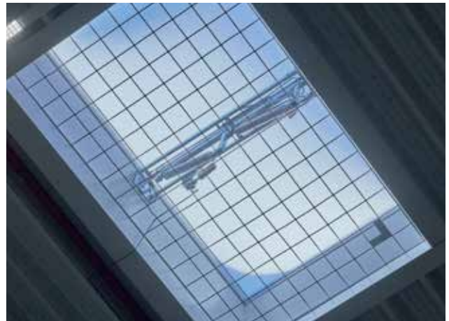
Auffangsicherung LK-L direkt unterhalb des Aufsetzkranzes montiert
